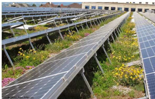
L'installation de panneaux solaires sur une toiture végétalisée permet d'augmenter son rendement (source : naturetoit.blogspot.com)
