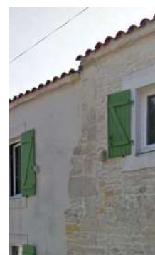
Façade dégarnie de son enduit
