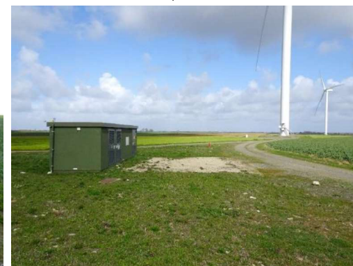
Traitement des postes de livraison
